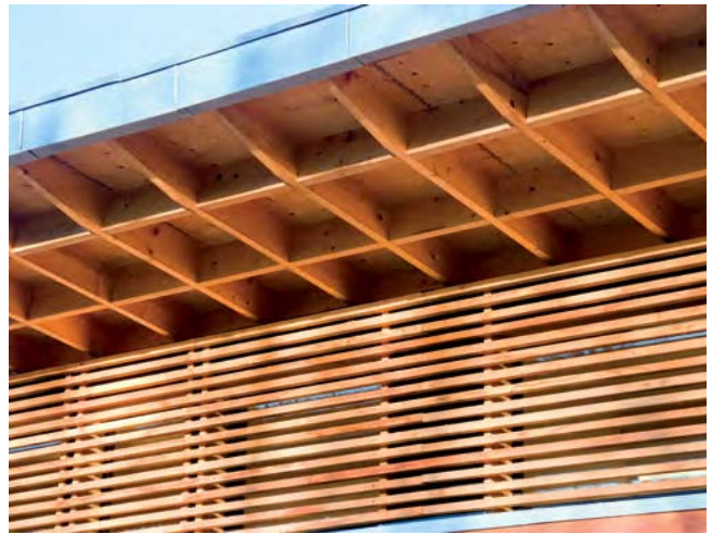
Les liaisons entre les brise-soleil et le débord de toiture en kerto ont été particulièrement soignées.
